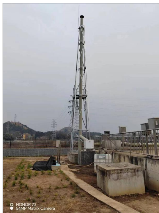
图 3-2 离子除臭装置
