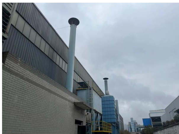
图3-1 气刨工序除尘器及15m高排气筒（DA003、DA006）
