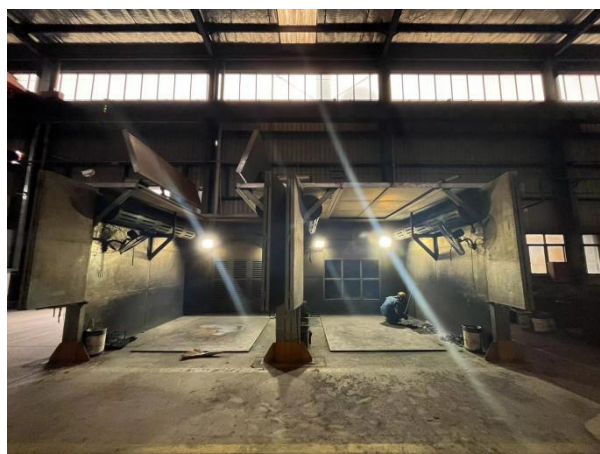
图 3-2 气刨工位收尘措施
