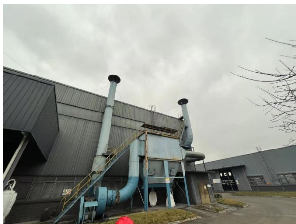
图3-4 振动落砂工序除尘器及15m高排气筒（DA004）
