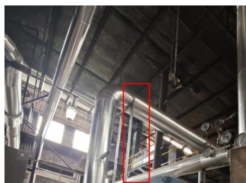
图 3-5：2#锅炉房 1800kw 导热油锅炉排气筒（DA004）
