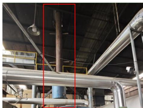
图 3-6：2#锅炉房 700kw 导热油锅炉排气筒（DA005）
