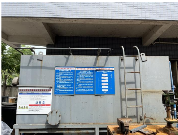
图 3-7：一体化污水处理设施
