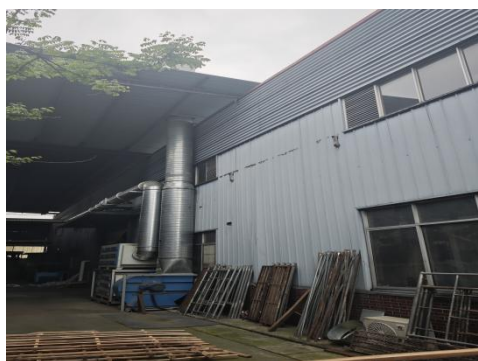
图 3-1：1#车间有机废气 15m 高排气筒（DA006）
